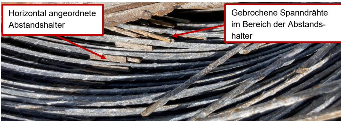
Abbildung 4.4d: Spanndrahtbündel mit Drahtbrüchen im Bereich der Abstandshalter.
