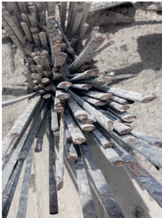
Abbildung 6.2c: Infolge Spannungsrisskorrosion bereits vor der Sprengung vollständig gerissenes Spannglied in Träger 3 Feld 2.2 nahe Auflager C
