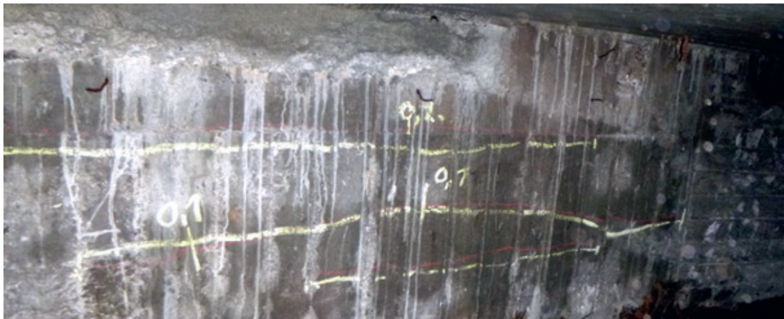
Abbildung 6.2a: Risse in den Stegen entlang der Spannkästen
