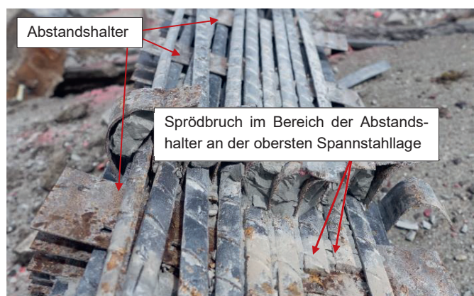
Abbildung 4.4i: Spanndrahtpaket im Auflager- bzw. Umlenkbereich mit Abstandshaltern horizontal und vertikal (Abstand nach TGL nicht geregelt)
