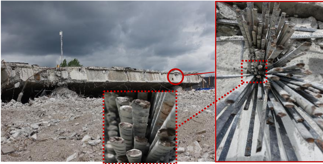
Abbildung 4.4b: Infolge wasserstoffinduzierter Spannungsrisskorrosion gerissenes Spanndrahtbündel in Träger 3 Feld 2.2 nahe Auflager C
