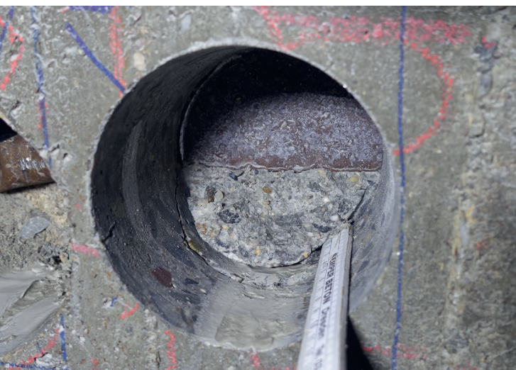
Abbildung 4.2b: von Spannkasten an schräg verlaufender Riss in Bohrstelle M3
