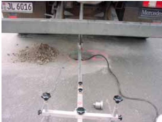
Bild 7: Bestimmung des statischen Verformungsmoduls E_{v2} im Bohrloch auf der alten ungebundenen Tragschicht
