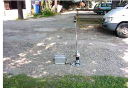
Bild 16: Tragfähigkeitsmessung mit dem Leichten Fallgewichtsgerät in einem Schlagloch der alten sandgeschlämmten Schotterdeckschicht vor der Verfüllung ( E_{vd} = 60\text{ MN/m}^2 )
