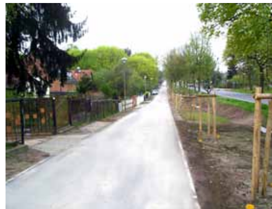
Bild 22: Nach Erneuerungsvariante E-Var. 4 erneuerte Wohnstraße mit 20 cm Verfestigung, 8 cm Schotterzwischen-schicht 0/22 und 10 cm Asphalt
