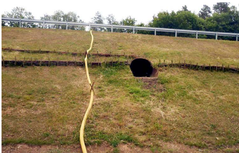
Abb. 16: Für die Wege der Fischotter wird zwischen dem „Kleinen Költch“ und dem „Großen Költch“ ein 1500 mm breiter und insgesamt 30 m langer Rohrtunnel gebaut.
