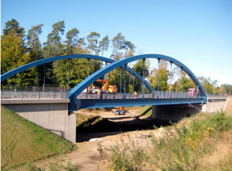
Abb. 12: Nach Inbetriebnahme des neuen Bauwerkes wird die alte Brücke abgerissen und die Radweganschlüsse fertiggestellt.
