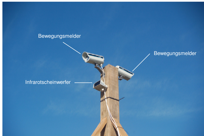
Abb. 6: Bewegungsmelder und Infrarotscheinwerfer auf dem Holzpodest
